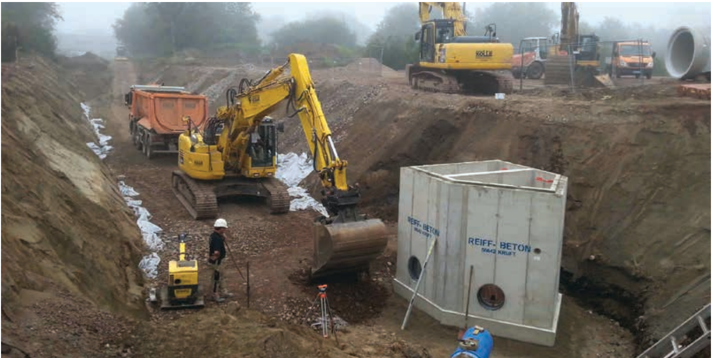
Wichtiges Element des Stauraumkanals ist ein Drosselschacht. Dieses Betonfertigteil reduziert und reguliert bei starken Regenereignissen den Durchfluss von Regenwasser. | Foto: Kolle GmbH
